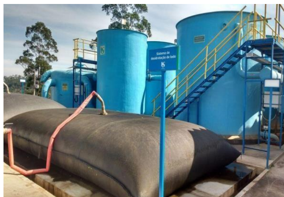
Figura 2: Desidratação do Lodo da ETA
